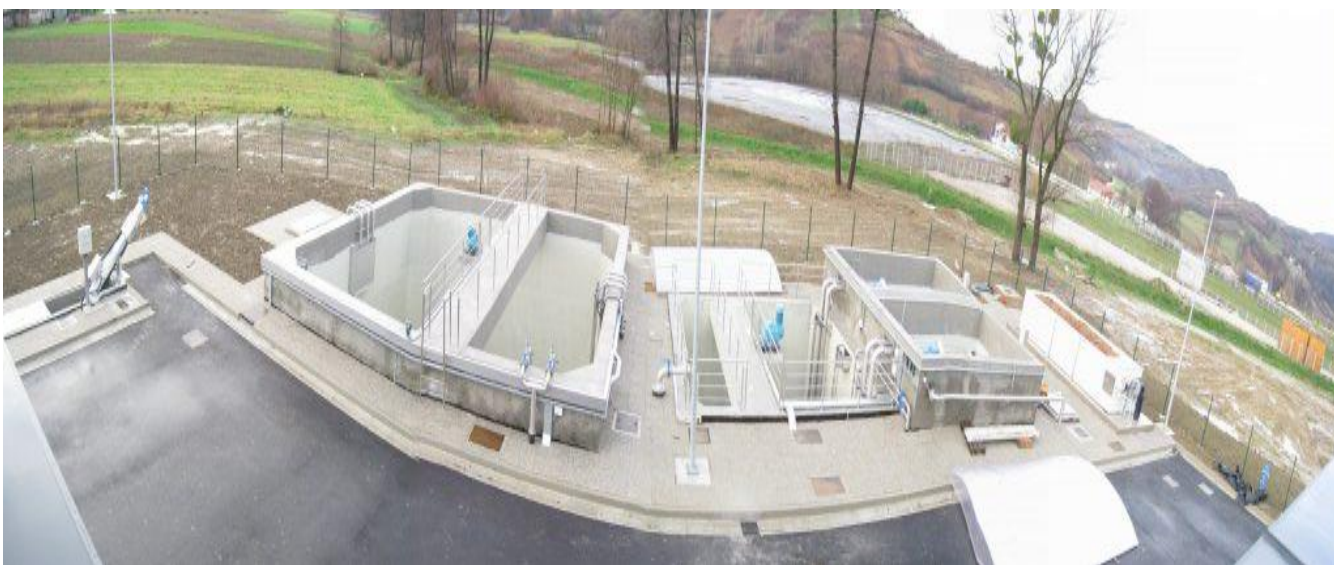
Slika 7: uređaj za pročišćavanje otpadnih voda Jamnica [19]
