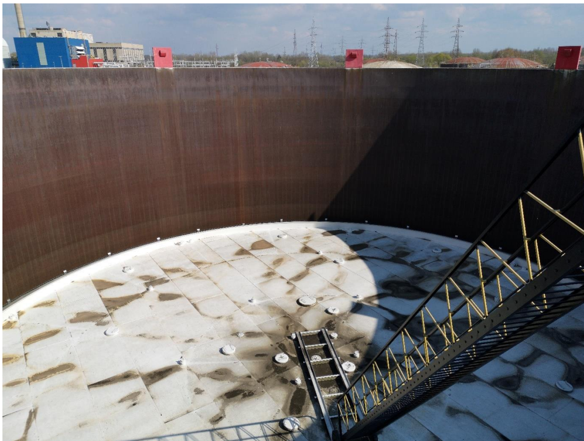
Slika 4. Plivajući krov spremnika s pristupnom ogradom [4]
