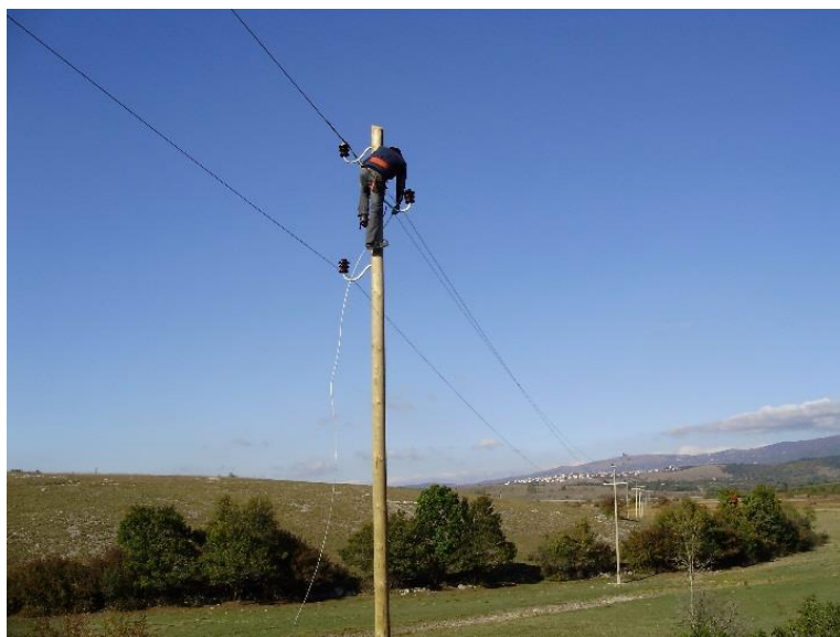
Slika 8. Nadzemni 10(20) kV dalekovod [12]
