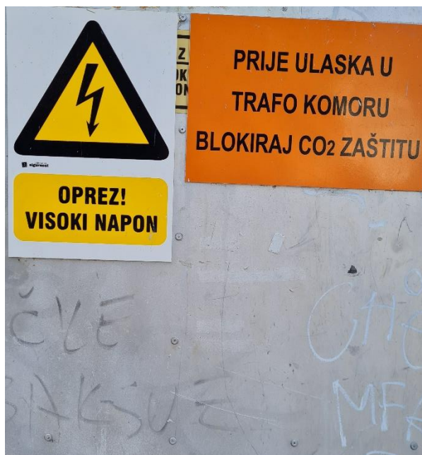
Slika 5. Prikaz ulaza u trafo komoru [9]
