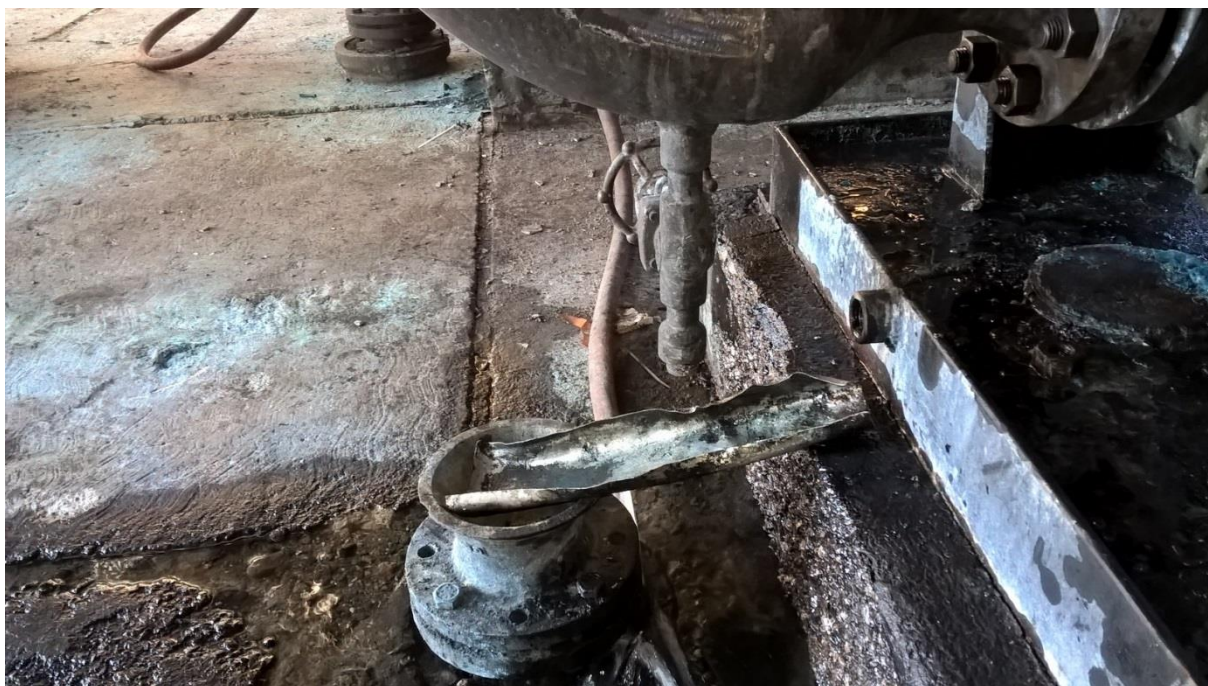
Slika 6. Drenaža pumpe ukapljenog naftnog plina 321 MP-012A [4]
