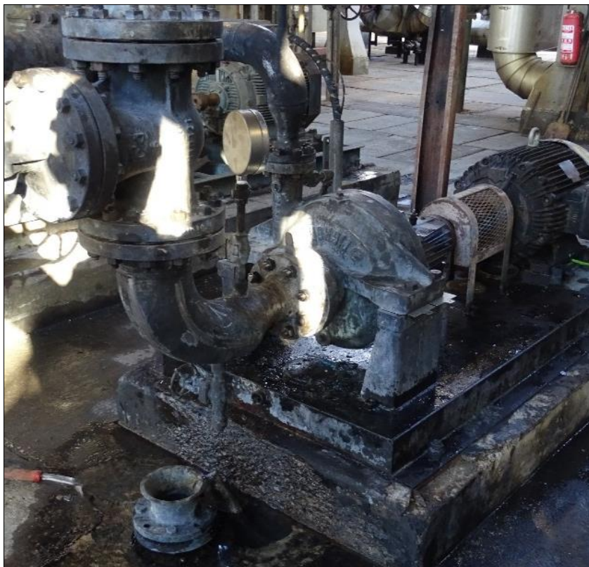
Slika 12. drenaža pumpe 321 MP-012A nakon požara [4]
