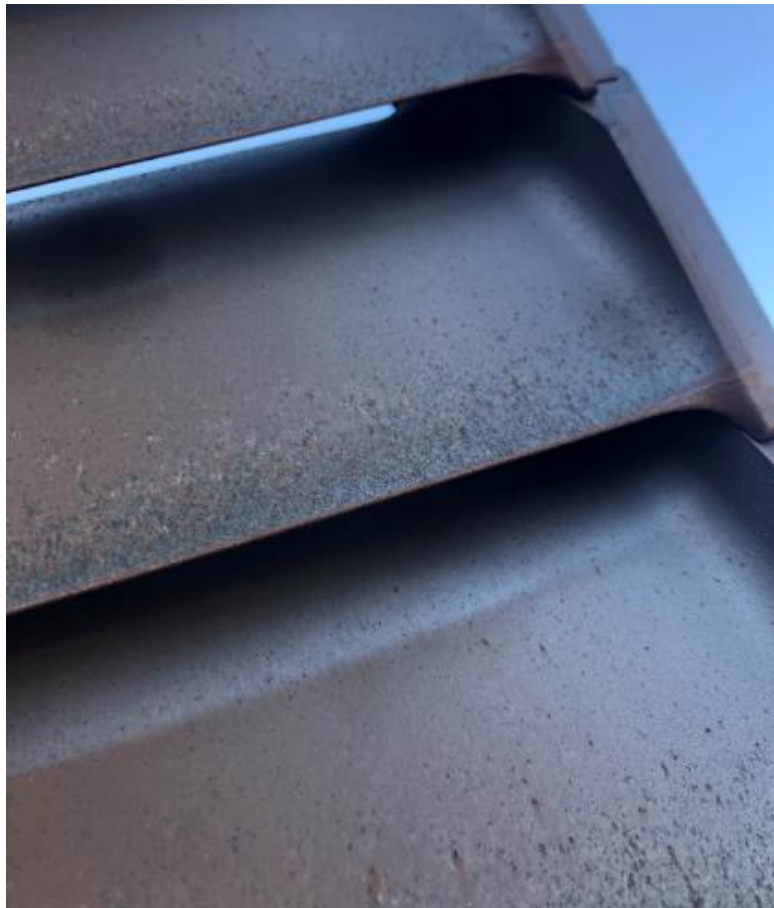
Slika 16. Oštećenje uzrokovano krutim česticama
