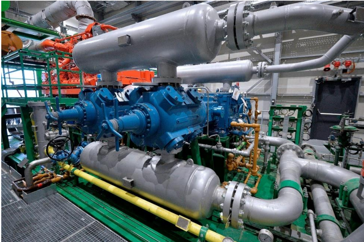
Slika 5. Kompresorska stanica na plinskom transportnom sustavu
