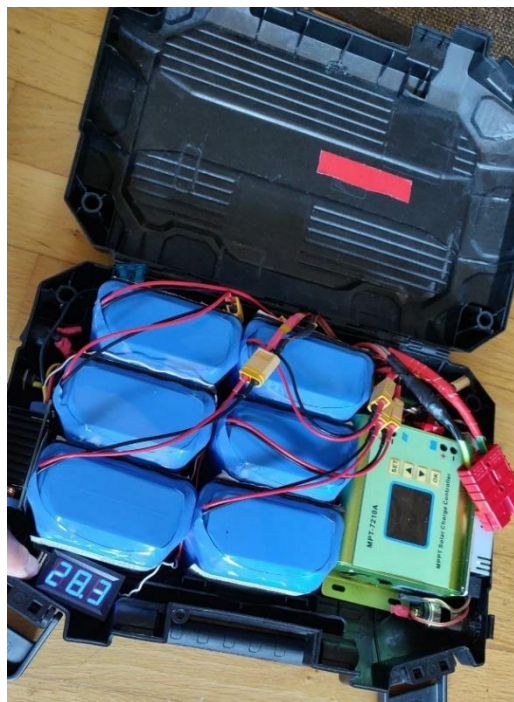
Slika 49. Pogled unutar kućišta
