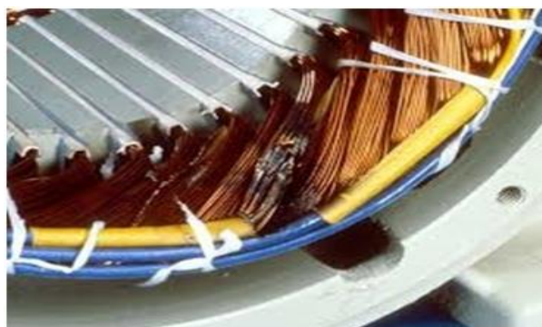
Slika 3. Oštećeni elektromotor (Izvor: www.pinterest.com )
