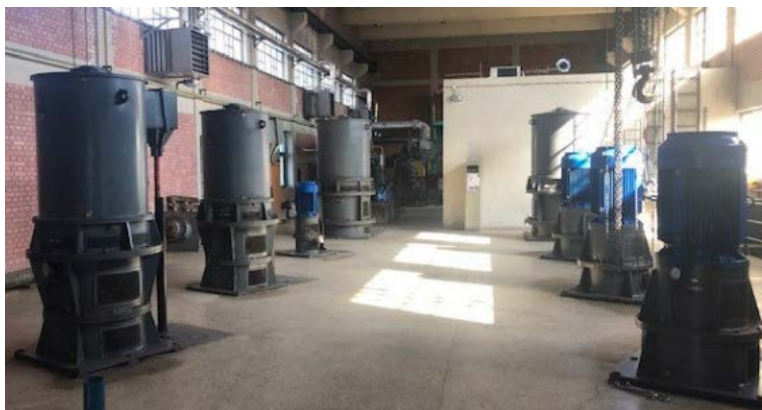
Slika 7. Unutrašnjost pumpaonice sa pumpama.[5]
