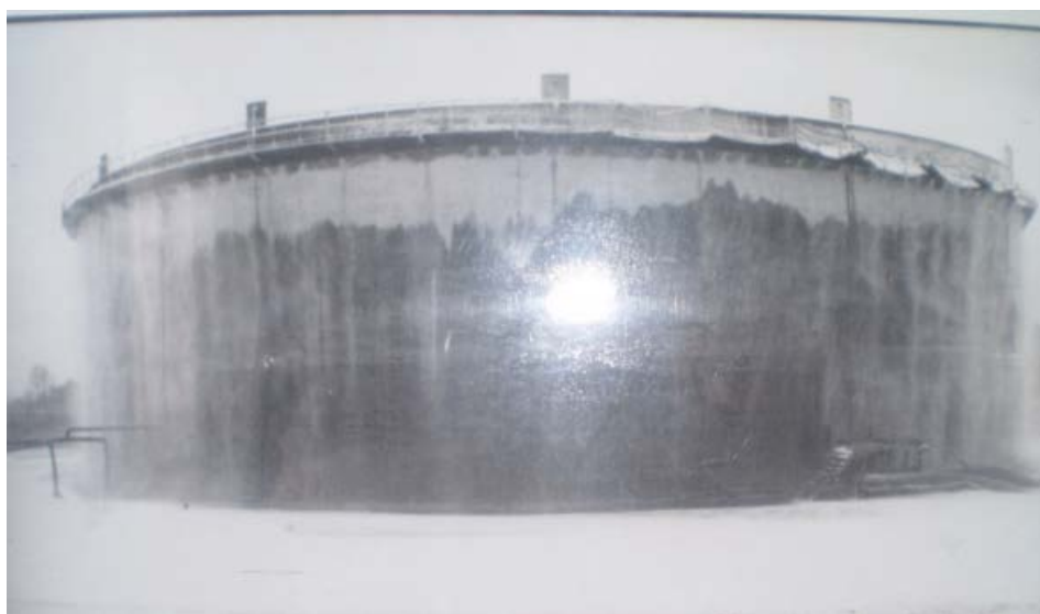
Slika 23. Spremnik R-802 nakon završene akcije gašenja požara.[8]
