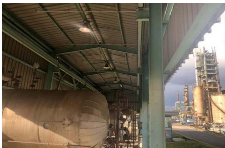
Slika 13. Drencher sustav mlaznica.[5]
