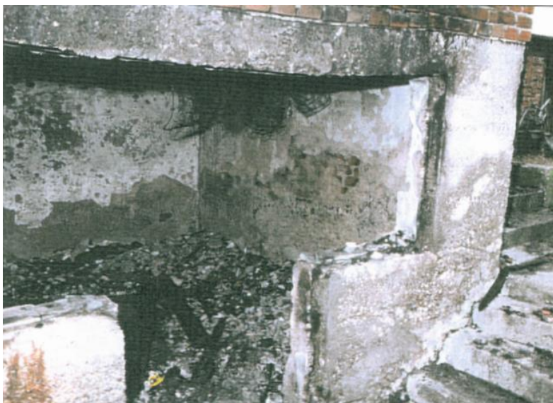
Slika 26. Vidljivi progib koji je nastao kao posljedica gašenja vodom [10]
