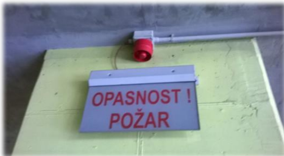
Slika 13. Signalizacija dojave požara (Izvor: Autor)
