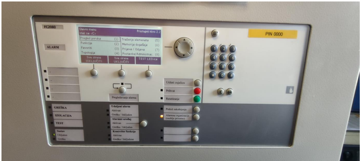
Slika 3. Uvećani prikaz vatrodojavne centrale (Izvor: Autor)
