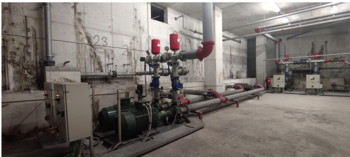
Slika 8. Pumpe u sprinkler stanici (Izvor: Autor)
