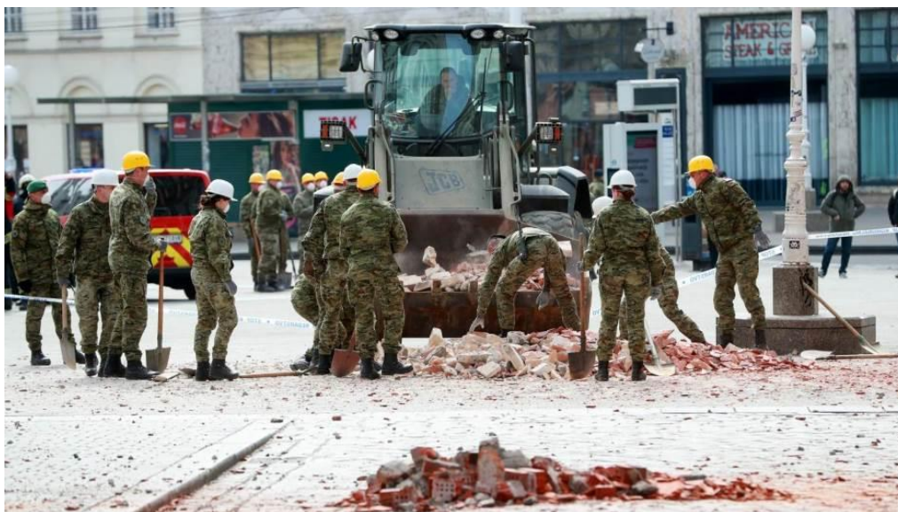
Slika 4. Uklanjanje ruševina s ceste nakon razornog potresa u Zagrebu [7]
