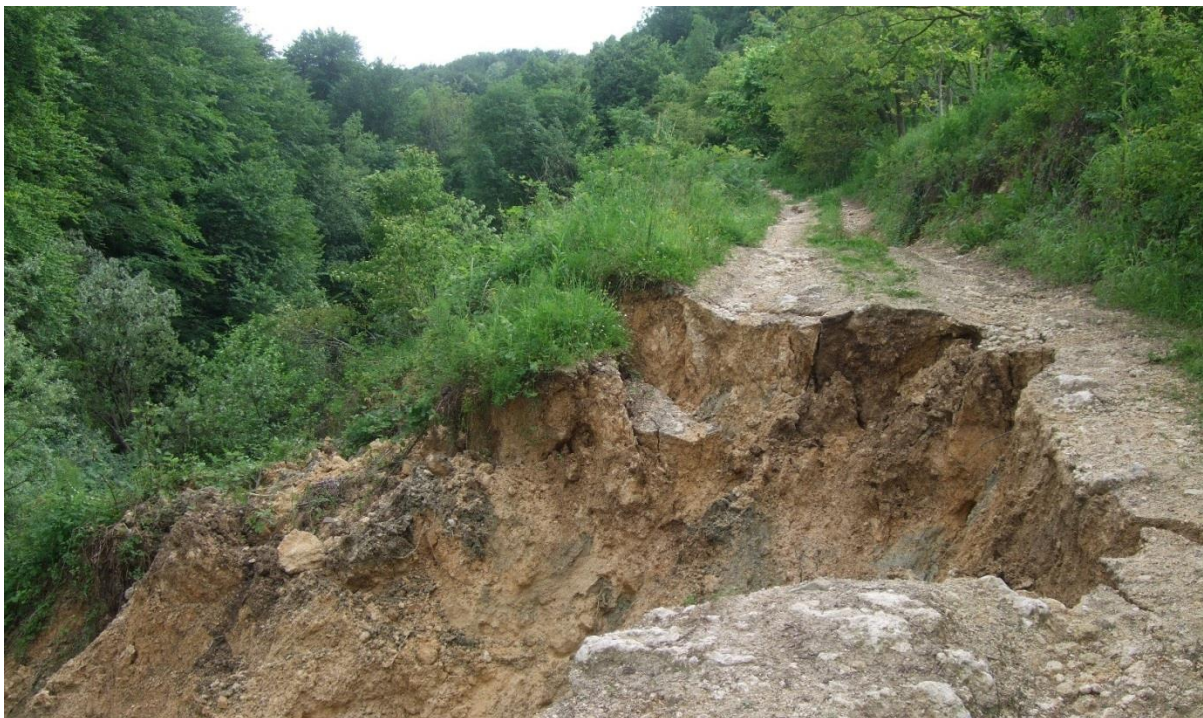
Slika 8. Prikaz djelovanja erozije na tlo.
