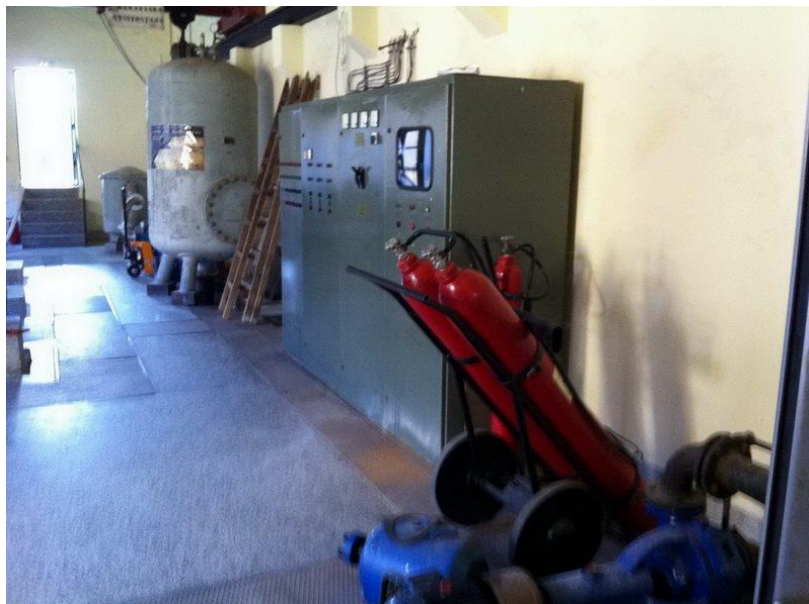
Slika 6: Niskonaponski upravljački ormar
