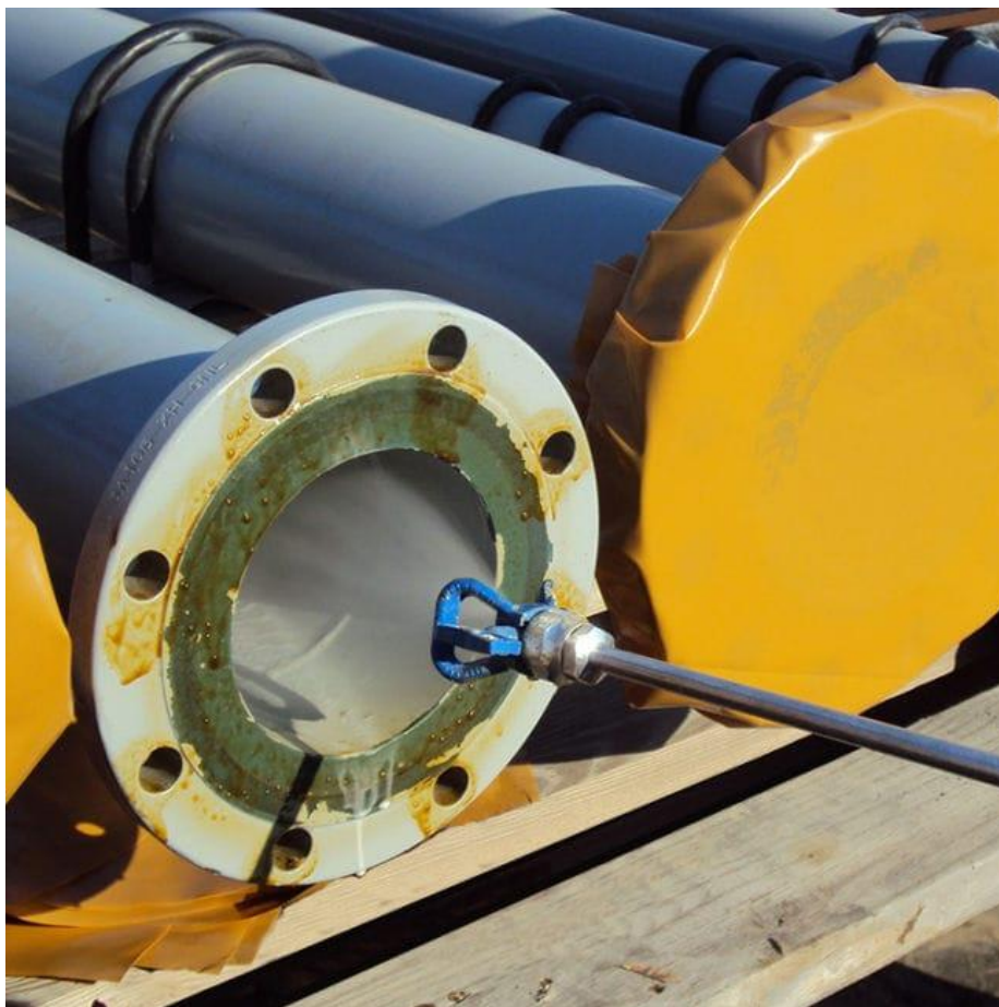
Slika 14. Primjer primjene inhibitora korozije u cjevovodima [29]
