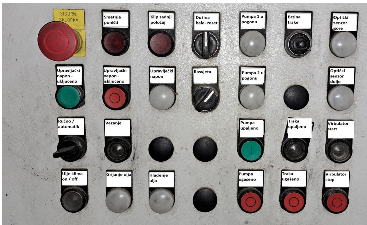
Slika 16. Vanjski dio upravljačkog ormara
