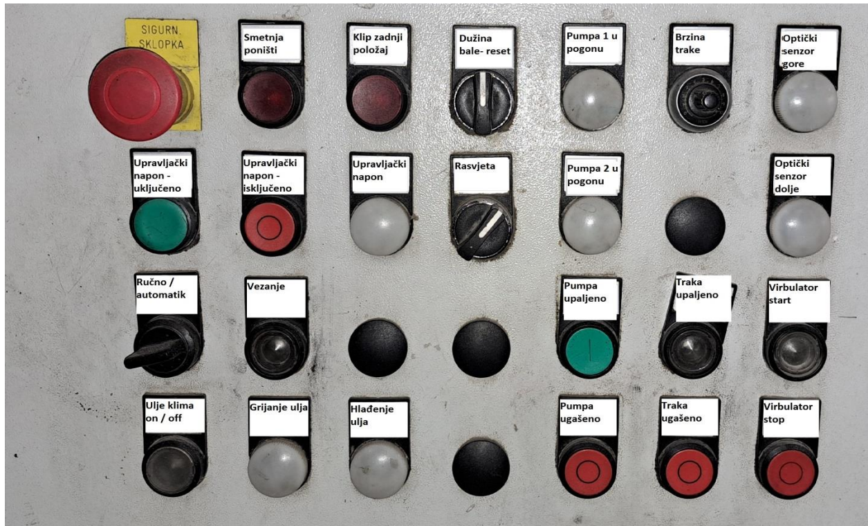
Slika 16. Vanjski dio upravljačkog ormara
