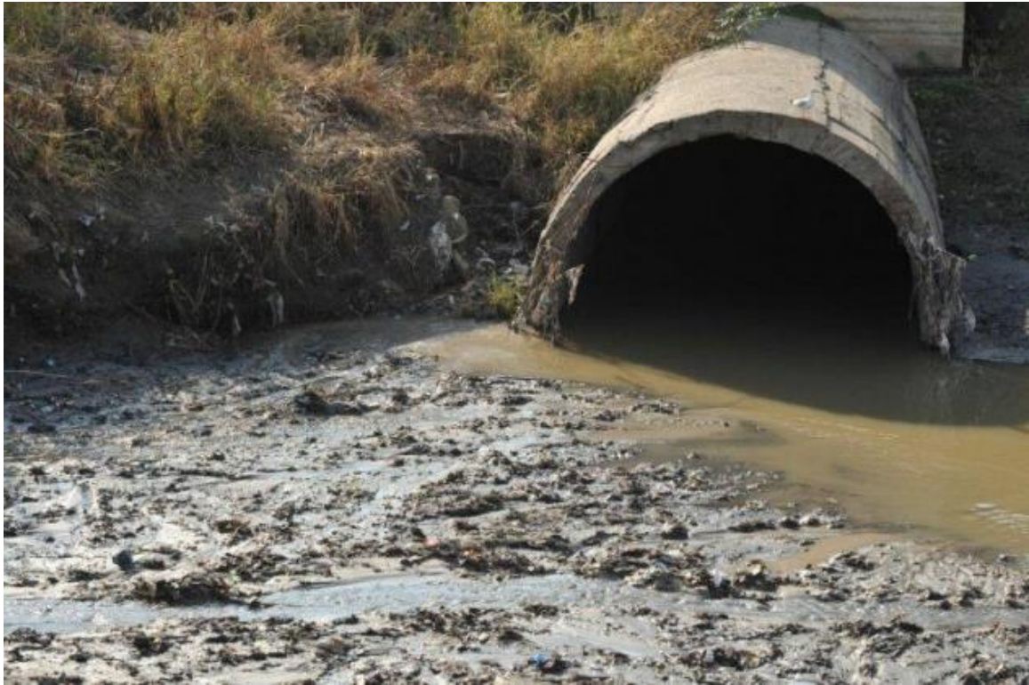
Slika 2. Prikaz neadekvatnog zbrinjavanja otpadnih voda
