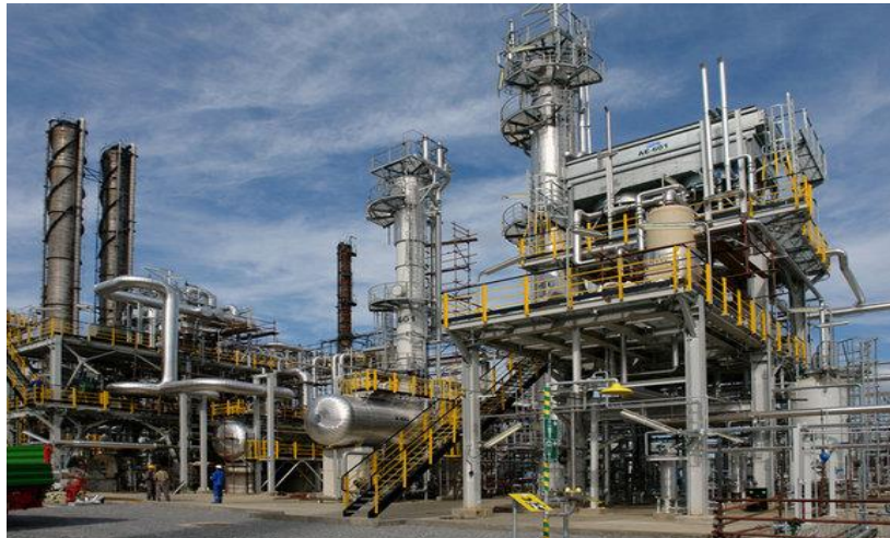
Slika 1: Postrojenje Rafinerije nafte Sisak [10]
