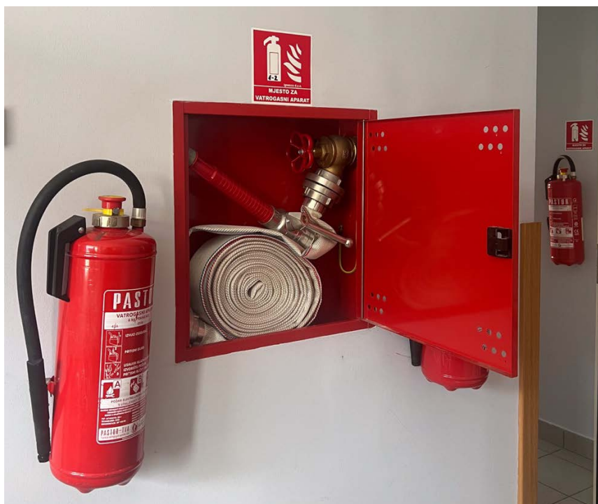
Slika 19. Aparati za gašenje požara i zidni hidrant, vlastiti izvor autora
