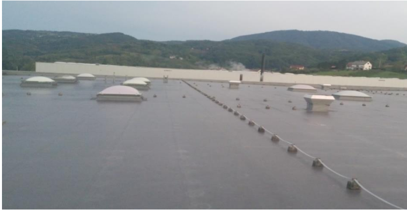
Slika 12.: Sustav obrane od groma na krovu pogona Jana
