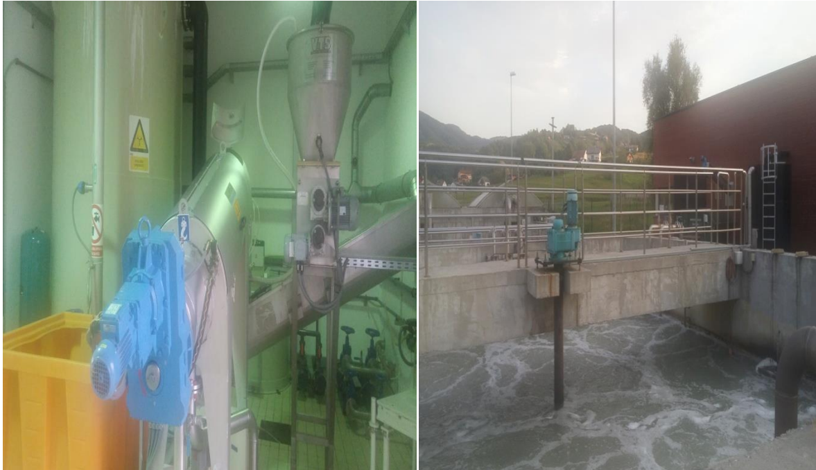
Slika 24.: Unutarnji i vanjski dio sektora za pročišćavanje otpadnih voda
