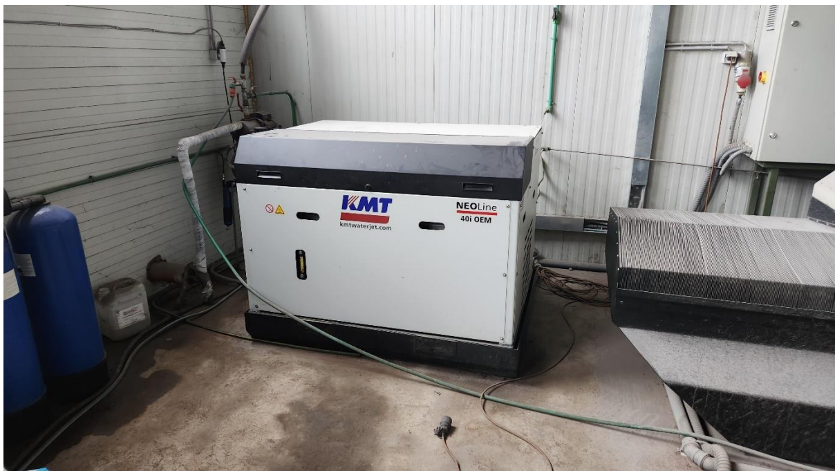
Slika 35. Kućište sustava niskog i visokog tlaka vode
