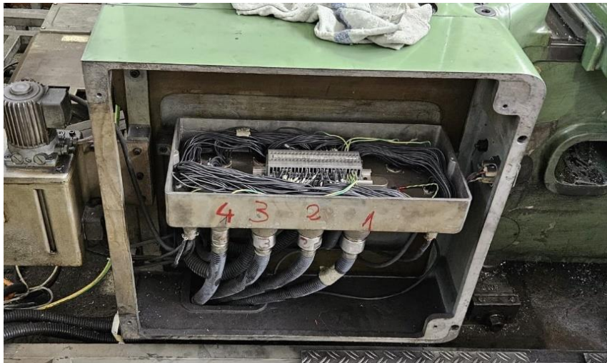
Slika 23. Potreban poklopac instalacija[Autor]
