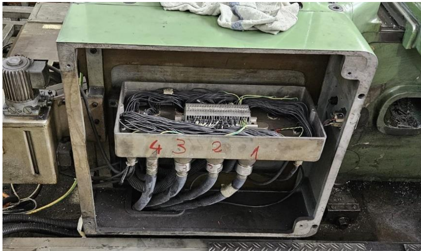
Slika 23. Potreban poklopac instalacija[Autor]
