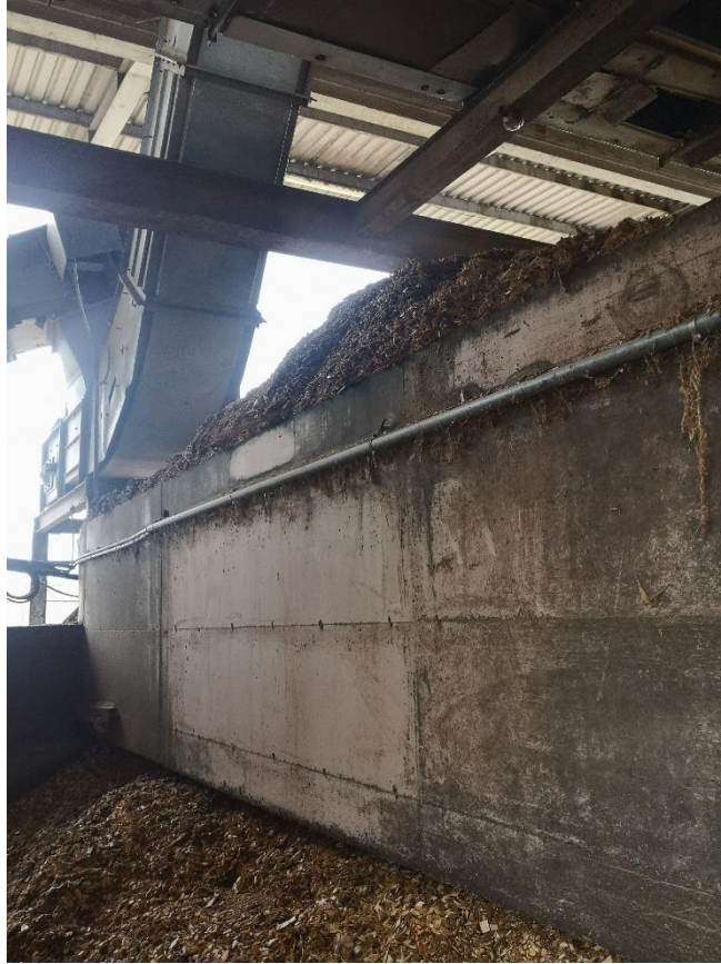
Slika 29. Termički javljač u dnevnom spremniku sječke [5]
