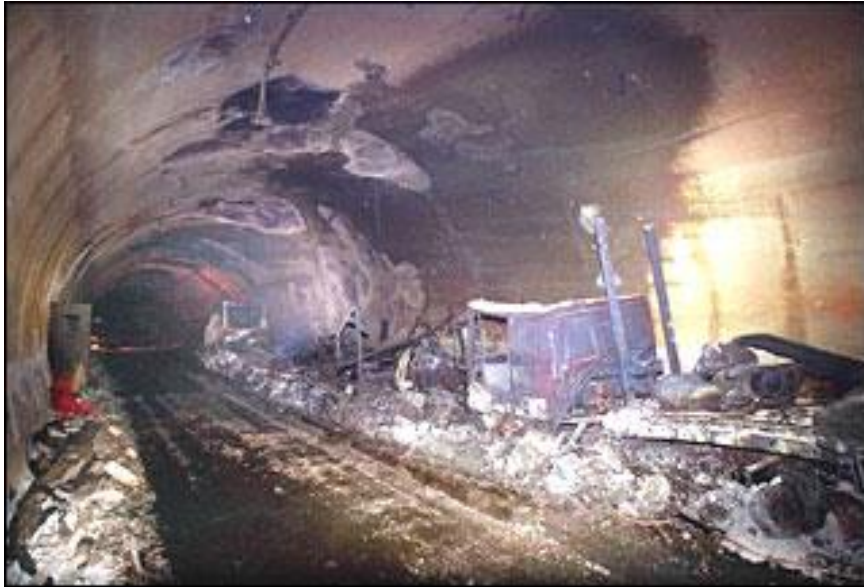
Slika 1. Slika nakon požara u tunelu Mont Blanc.
