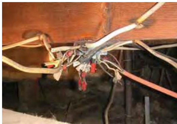
Sl. 2. Stare električne instalacije [3]
