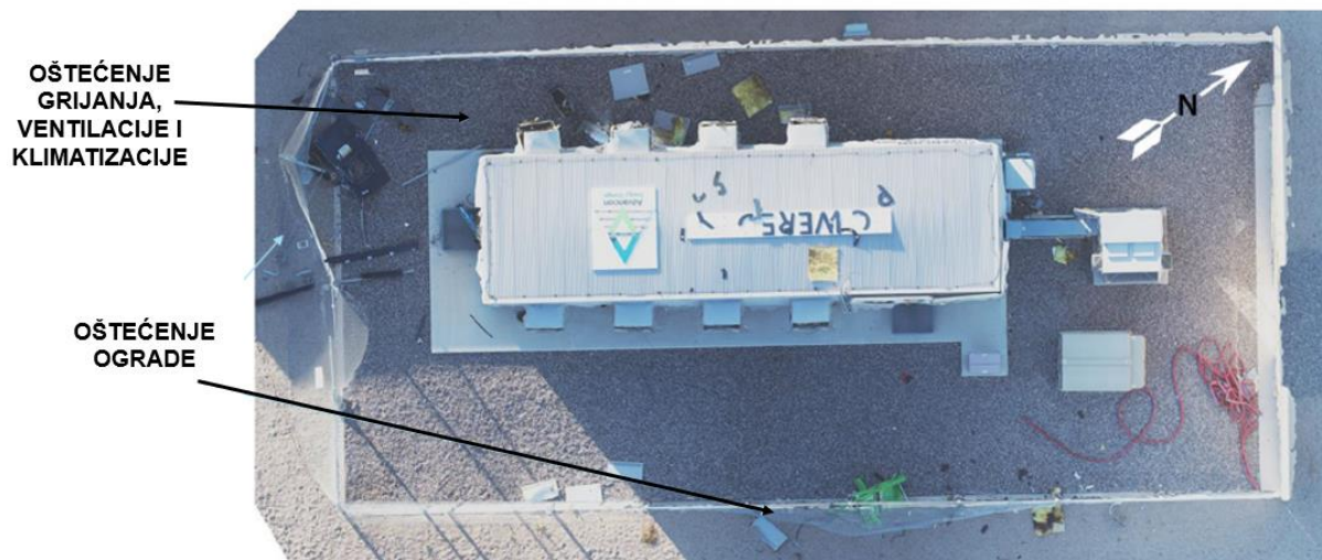
Slika 14. Postrojenje McMicken Battery Energy Storage nakon eksplozije [28]
