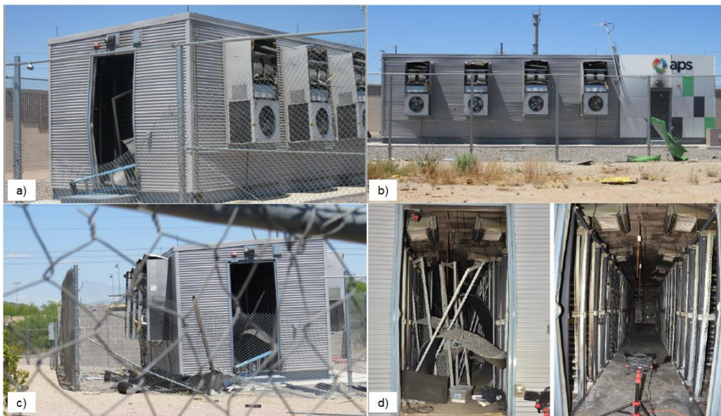
Slika 18. Prikaz postrojenja McMicken BESS-a nakon eksplozije, pod a) oštećenje stražnjih vrata i HVAC sustava, b) izbačena bočna vrata, c) krhotine i oštećenja stražnjih vrata i d) unutarnje oštećenje sustava [28]
