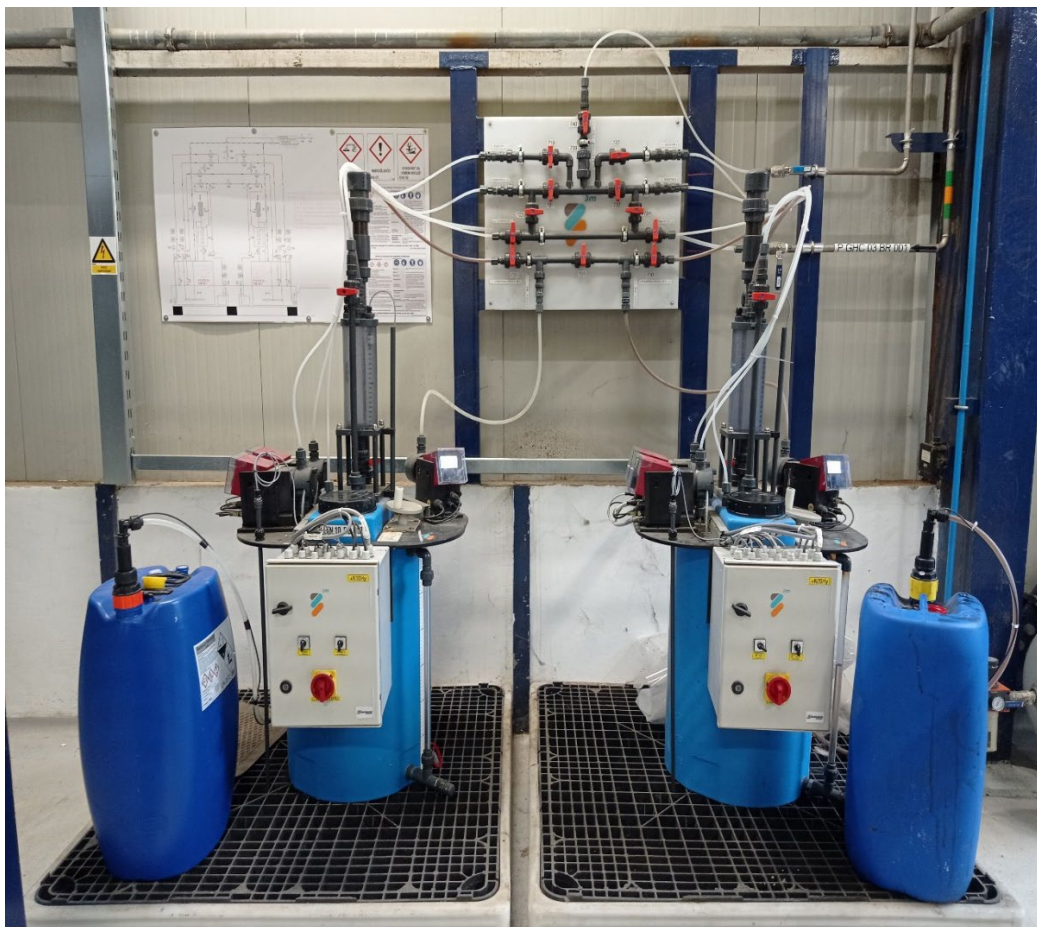
Slika 16. Dozirna stanica niskotlačnog kotla NTK3 [23]
