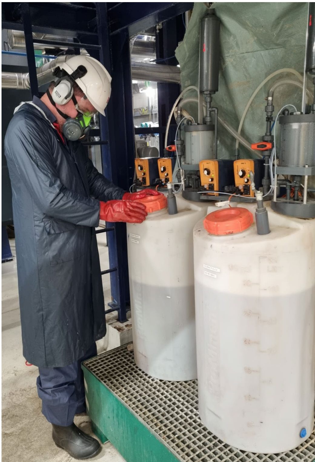
Slika 15. Dozirna stanica niskotlačnih kotlova NTK1 i NTK2 [22]
