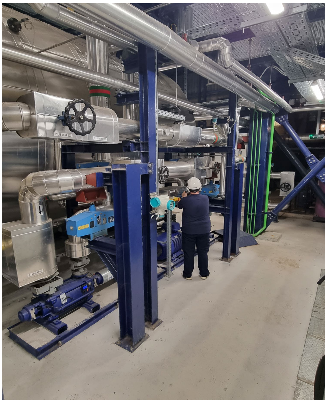
Slika 7. Niskotlačni kotao NTK3 [11]
