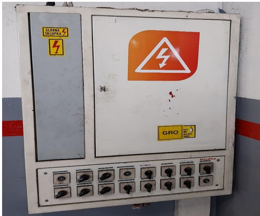
Slika 10. Glavni razvodni ormar [16]
