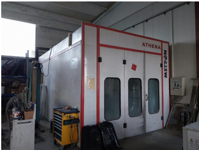
Slika 12. Komora za lakiranje sa sustavom ventilacije [16]
