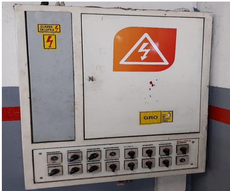
Slika 10. Glavni razvodni ormar [16]
