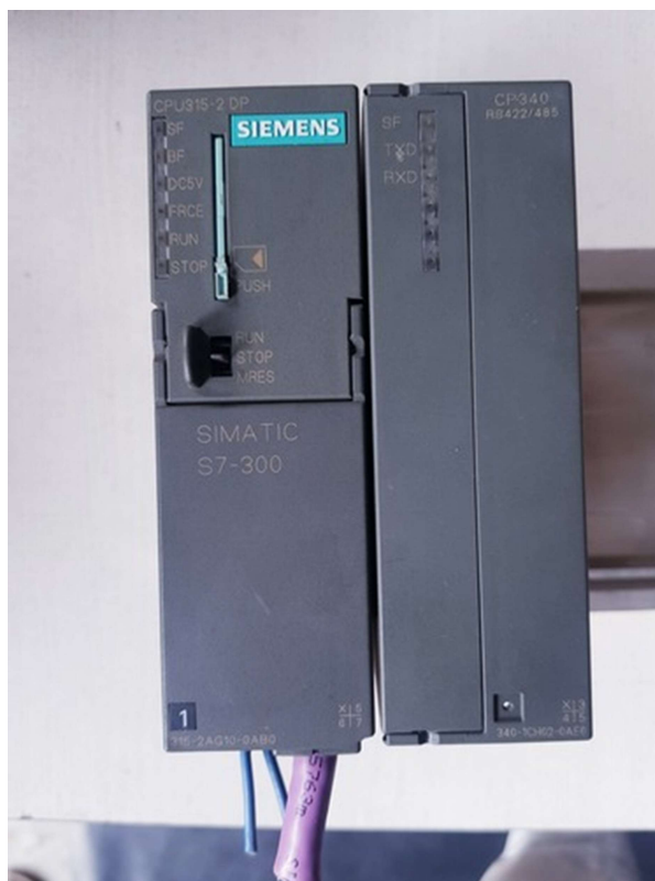
Slika 5. PLC Simatic s7-300 (izvorno autor)
