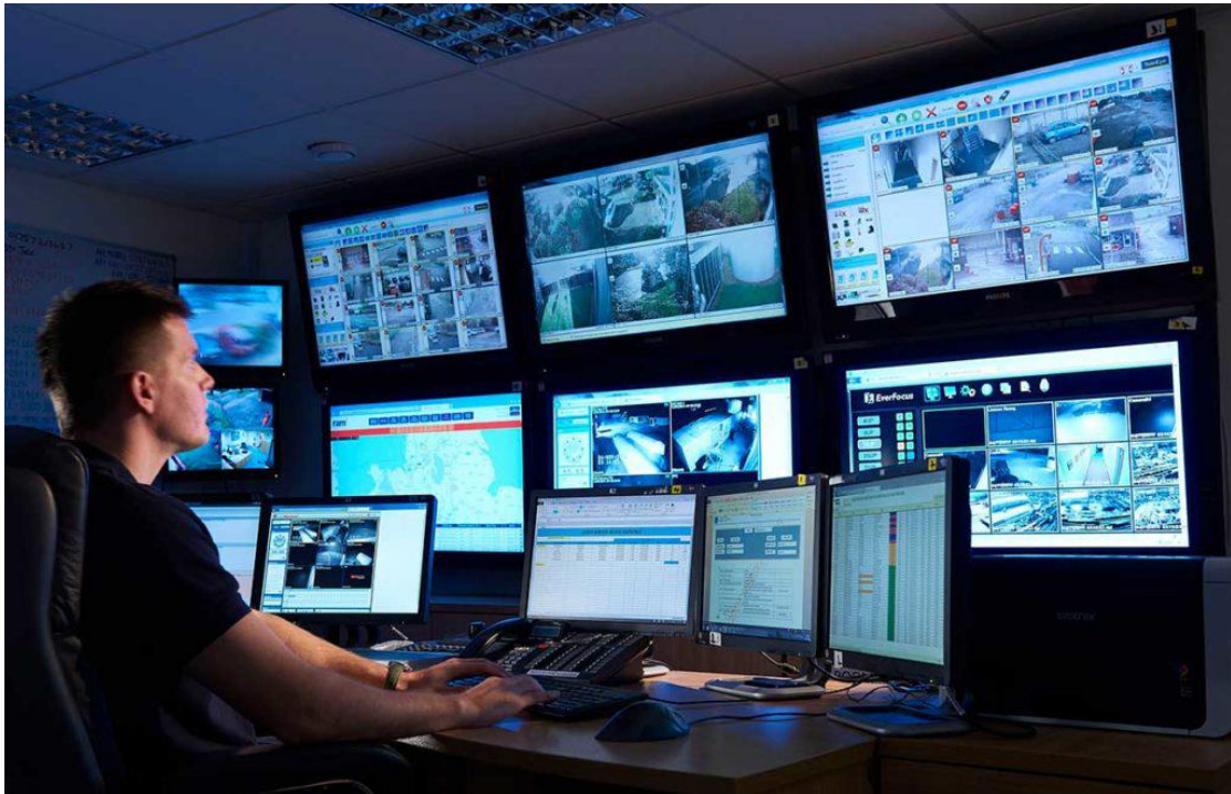
Slika 3.2. Prikaz kontrolne sobe, centralni dojavni sustav [4]
