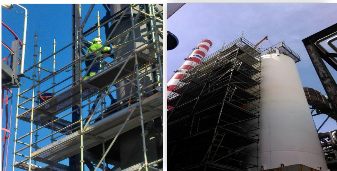
Slika 2. Pravilno složena laka skela u rafineriji
