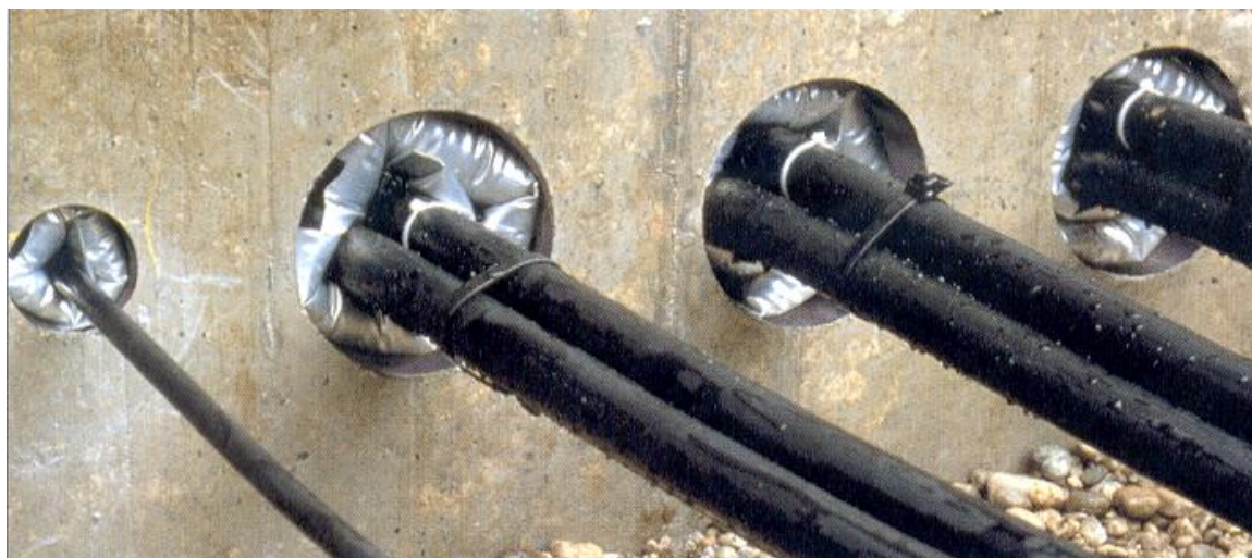
Slika 25: Prikaz zaštite prolaza kroz uvedne kanale trafostanice
