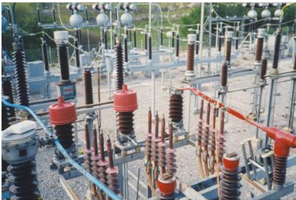
Slika 5: Rasklopno postrojenje u fazi izrade izolacije
