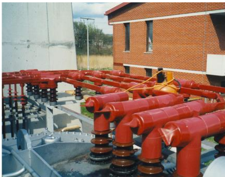
Slika 8: Izolirane transformatorske sabirnice
