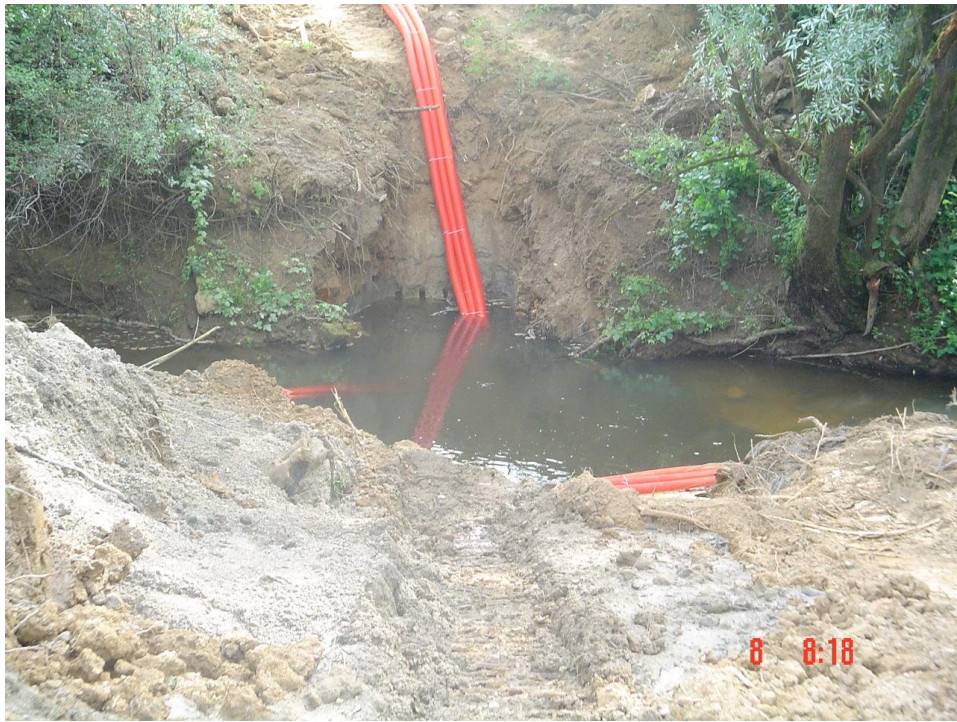
Slika 4: Elektroenergetski kabelski vod (prelaz preko potoka)
