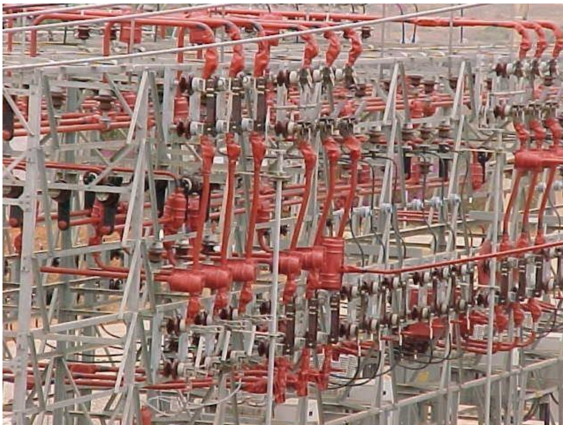
Slika 22: Izolirano elektroenergetsko postrojenje
