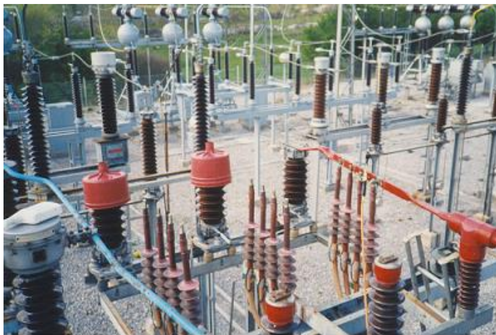
Slika 5: Rasklopno postrojenje u fazi izrade izolacije
