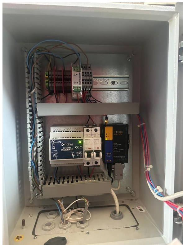
Slika. 12 Unutrašnjost razvodnog ormarića Izvor: Autor
