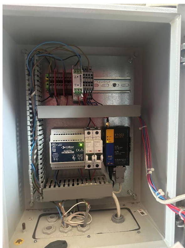
Slika. 12 Unutrašnjost razvodnog ormarića Izvor: Autor
