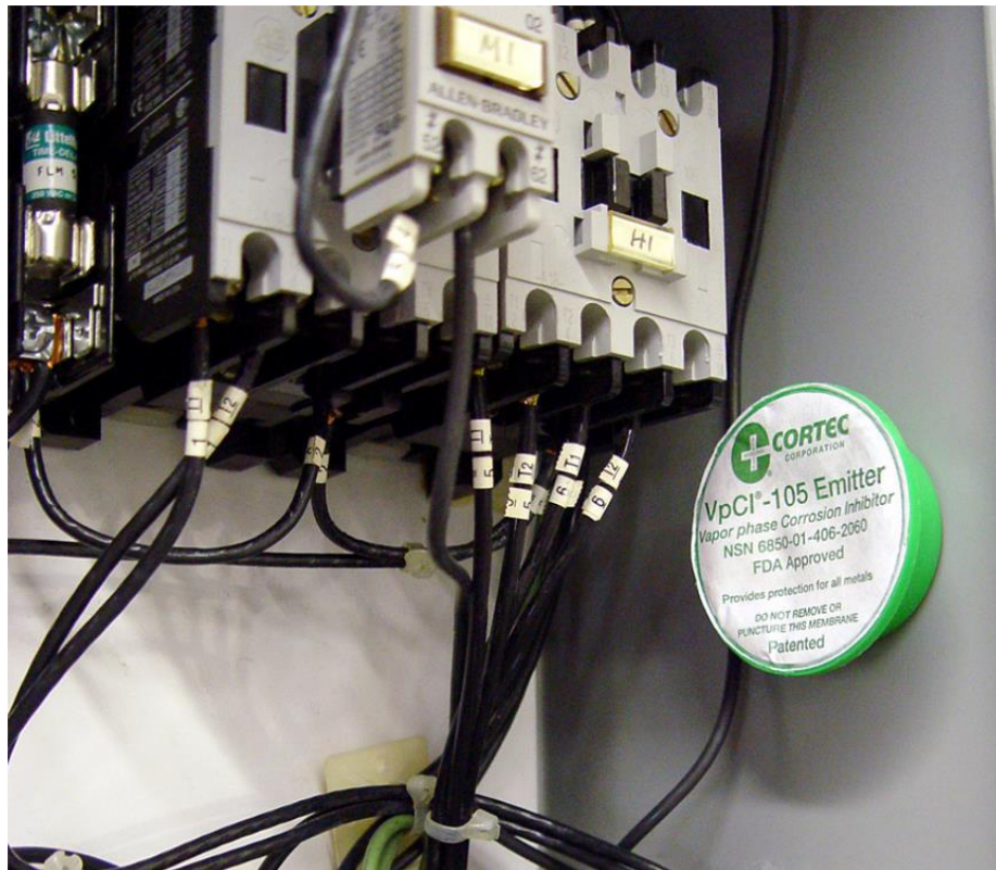
Slika 33. Inhibitor koroziije u razvodnom ormaru. [17]
