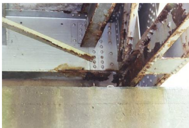
Slika 10. Korozija čeličnog mosta. [12]
