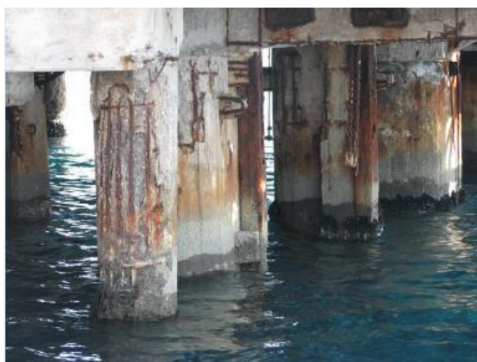
Slika 11. Korozija u betonu. [12]
