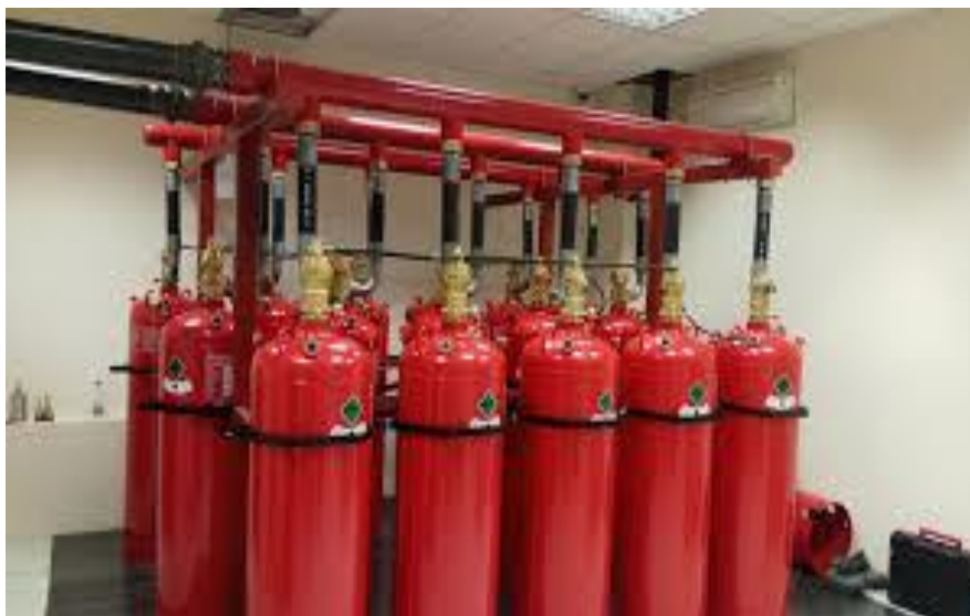
Slika 4. Sustav gašenja plinom NOVEC [1]
