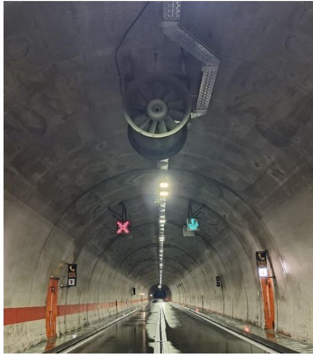
Slika 11. Ventilator u tunelu Brezovica [11]
