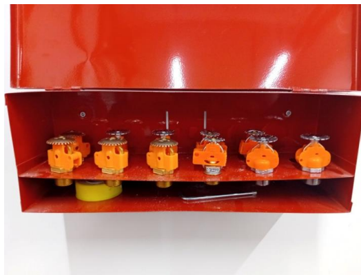
Slika 50. Rezervne sprinkler mlaznice u Stop&shop centru [21]
