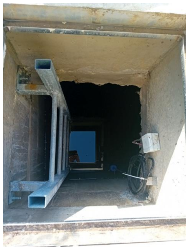
Slika 47. Otvor za ulaz u podzemno akumulacijski spremnik gdje se nalazi potopna sprinkler pumpa [21]
