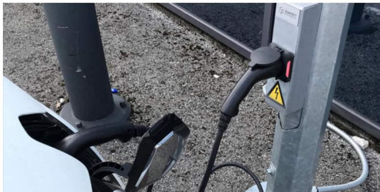
Slika 23. Punjač na rasvjetnom stupovima [14]
