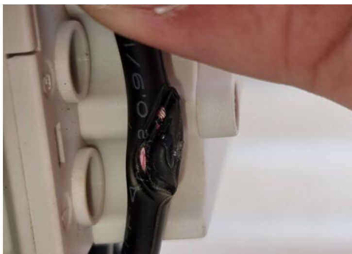
Slika 17. Prikleštene istosmjernog vodiča poklopcem kućišta [7]
