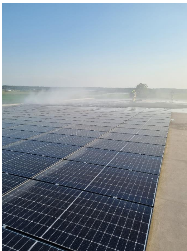
Slika 27. Požar ploče na krovu [11]
