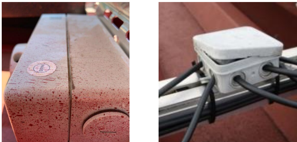
Slika 14. Slabo pritegnute vijke, koji uzrokuju neadekvatno brtvljenje [7]
