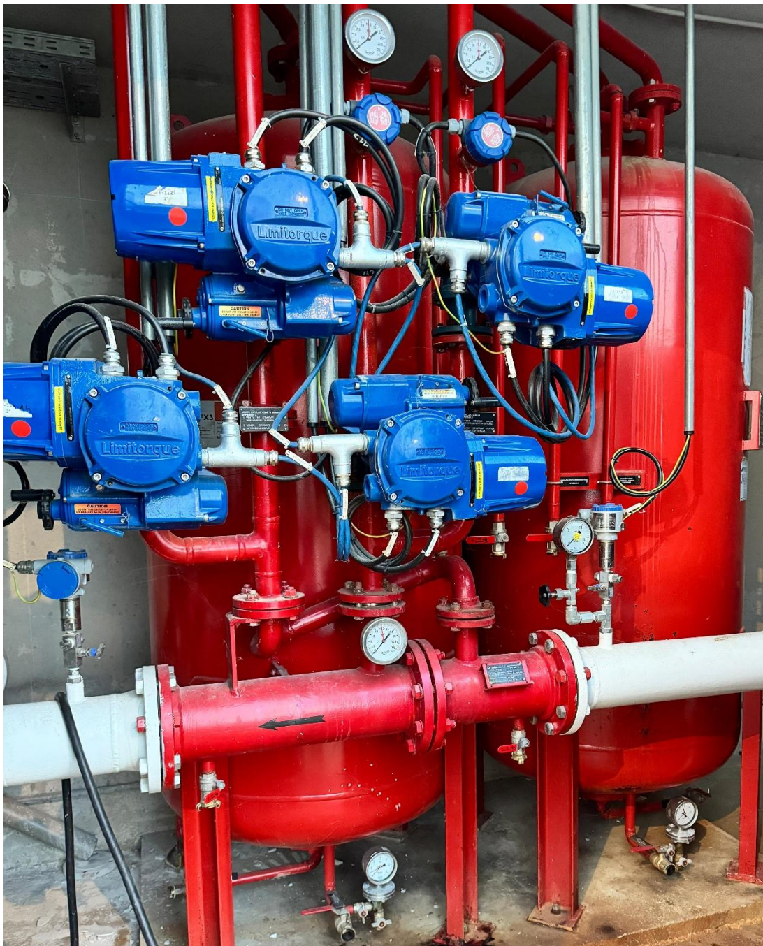
Slika 14. Spremnici s pjenilom od stabilnog sustava [19]
