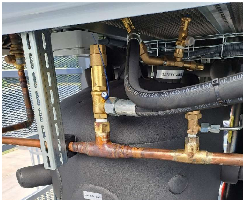
Slika 28. Ugrađeni priključak za rampu sa sigurnosnim ventilima
