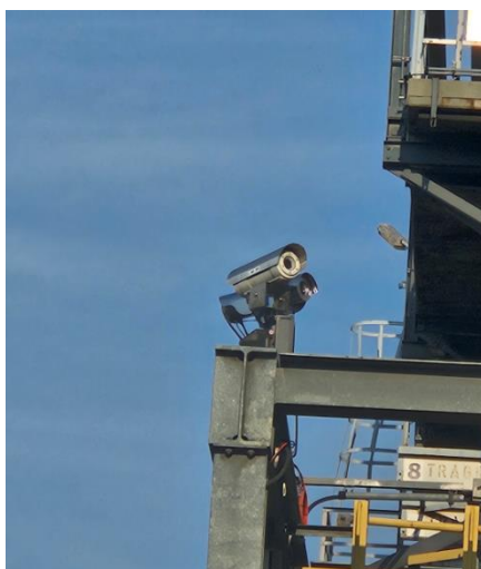
Slika 36. Kolone - javljači požara [1]
