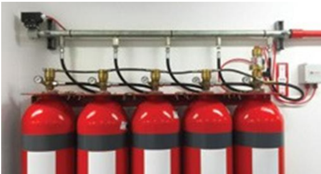
Slika 3. Cilindri inergena povezani u sustav [1]
