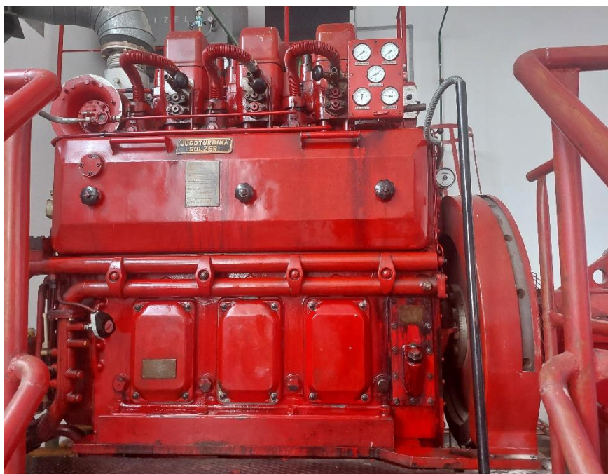
Slika 8. Pomoćna pumpa za vodu na diesel pogon [3]
