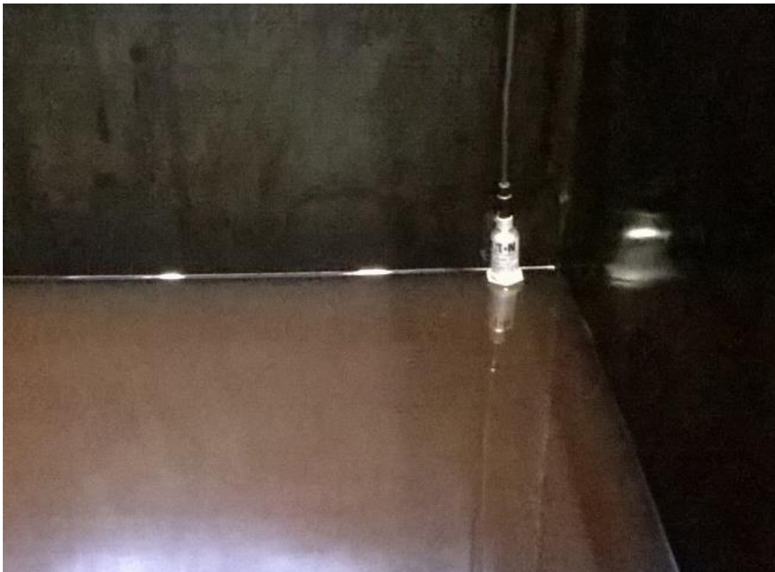
Slika 14. Mjerenje prisutnosti vode u spremniku generatorskog ulja
