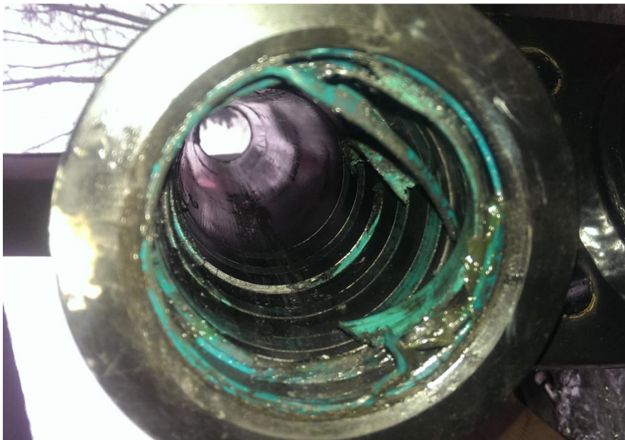
Slika 5 - Oštećenje na cilindru aktuatora
