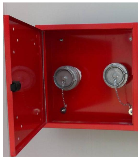
Slika 33. Predodžba priključka sprinkler sustava na vatrogasno vozilo
