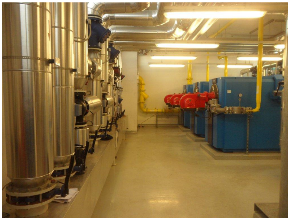
12. Slika: Primjer plinske kotlovnice snage od 3 MW
