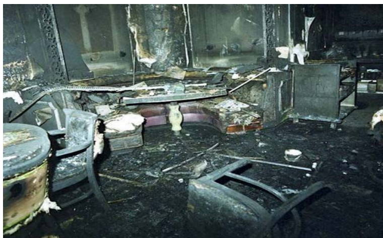
Slika 8: Zgarište restorana „Deli“ [21].
