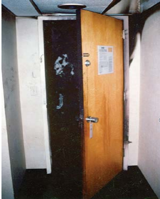
Slika 22 : Soba na desetom katu s minimalnom štetom [22].
