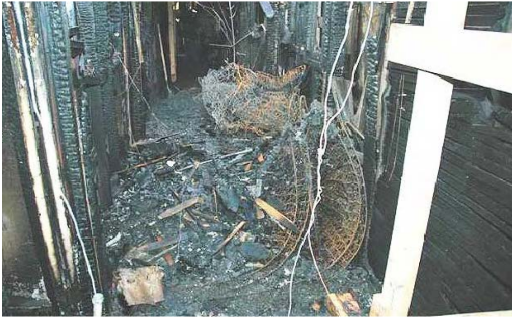
Slika 16: Prikazuje ostatke madraca u hodniku na 2. katu [23].
